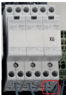
Abb. 95. Anschluss der Mischventilpumpe 2
