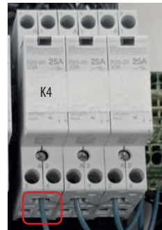
Abb. 93. Verbindung der Umwälzpumpe nach dem Plattenwärmetauscher
