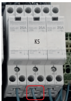
Abb. 94. Anschluss der Mischventilpumpe 1
